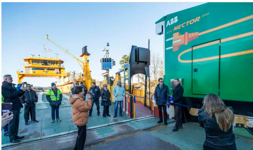
Testet. Trafikverket Färjerederiets testladdstation på Ljusterö som invigdes i februari 2020.
